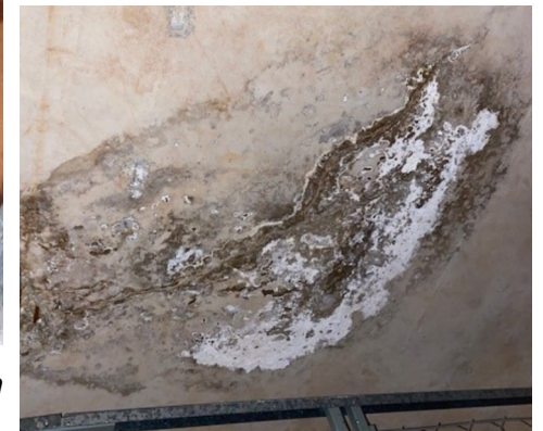
Läckage i källartak efter tidigare vattenskada
