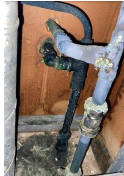
Fuktskada i schakt i badrum
