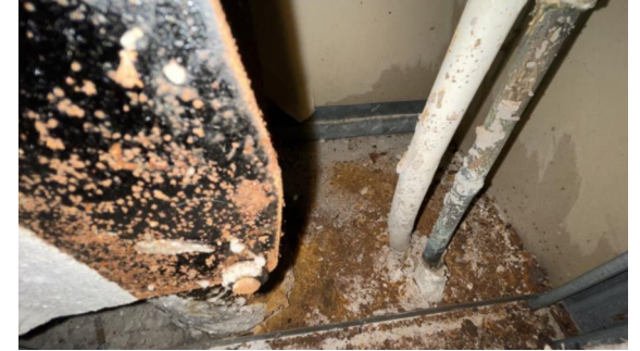
Fuktskada i schakt i badrum
