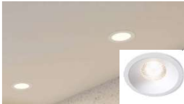
Vitmålat gipstak med infällda takspotlights. 4 st i badrum.
